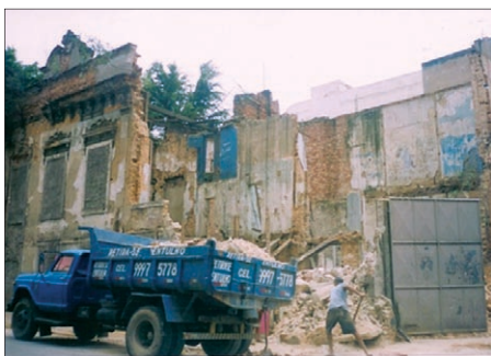
Em 2003, o imóvel estava em ruínas
