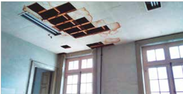
Buracos no forro facilitam a infiltração de chuvas
