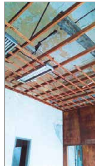
O interior do prédio precisa de reformas urgentes
